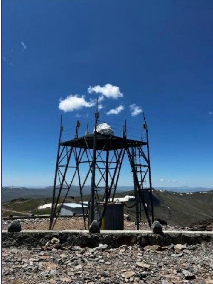
Şekil 33. ATM Kulesi Ağ Altyapısı Sağlanması.
